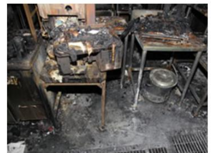
天かす火災により 厨房全体が焼損した建物火災
