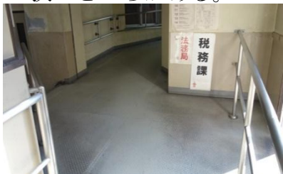
スロープのこう配が大きい
