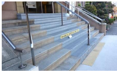
階段のけあげ（段の高さ）が大きい
