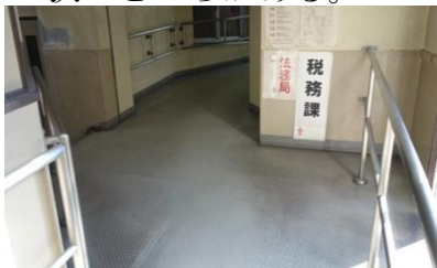
スロープのこう配が大きい
