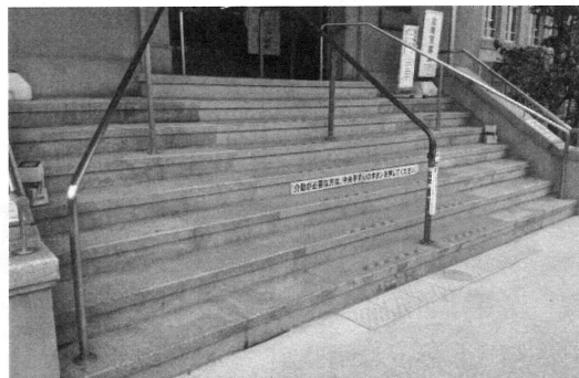
正面玄関前（階段の段の高さが大きい）
