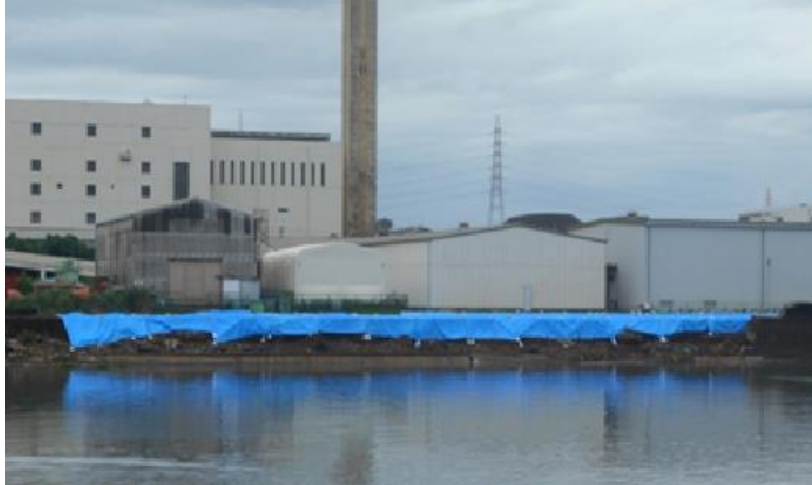
護岸損傷 (大牟田川)
