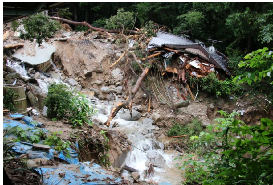
土砂流入被害(普光寺川)
