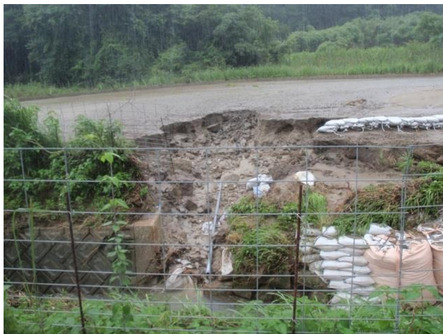
護岸損傷による田面の陥没(大字四ヶ)
