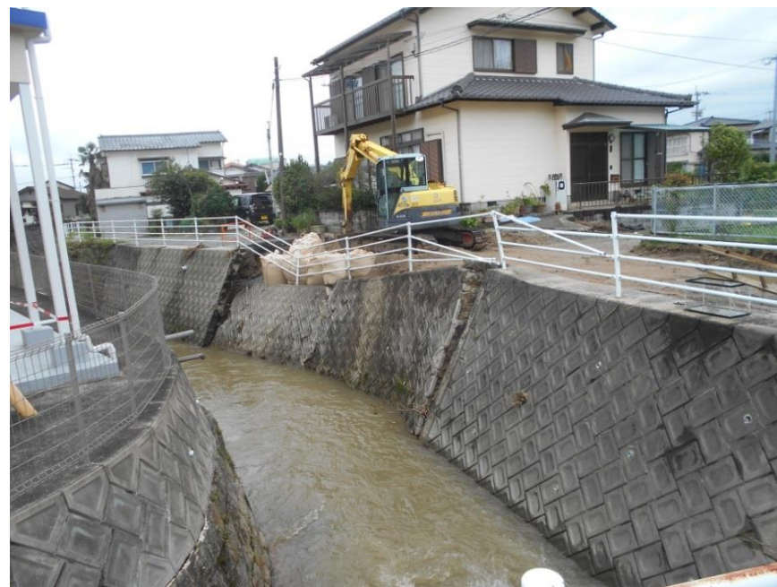
護岸損傷(堂面川)
