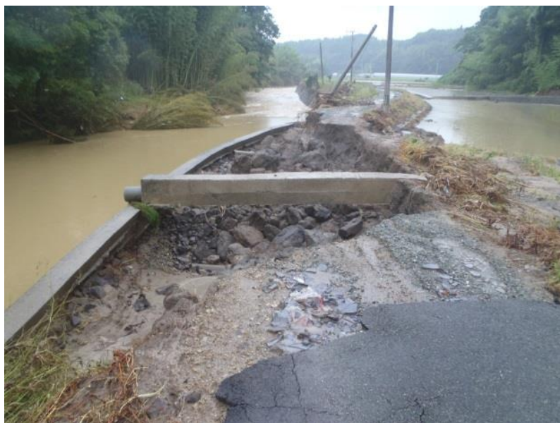
農道路面崩落(大字教楽来)
