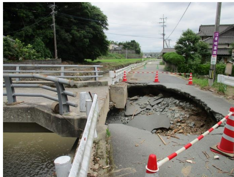
道路兼用護岸崩壊・陥没(大字岩本)
