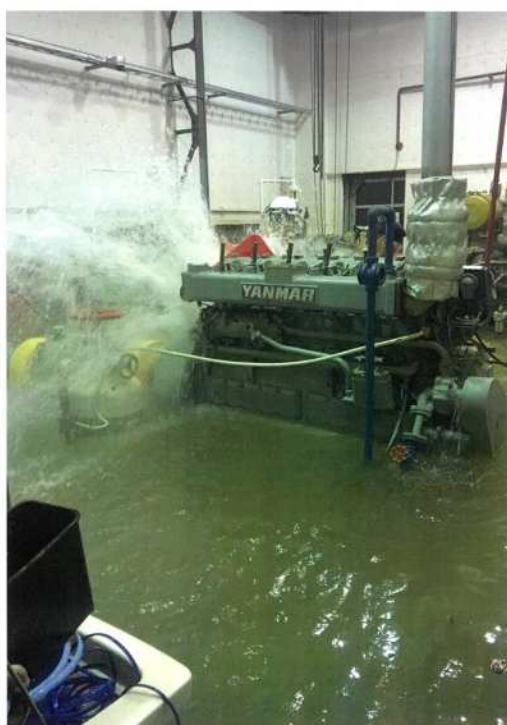
エンジンポンプ室
