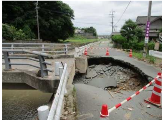
写真 3-1-9 ⑤道路兼用護岸崩壊・陥没
