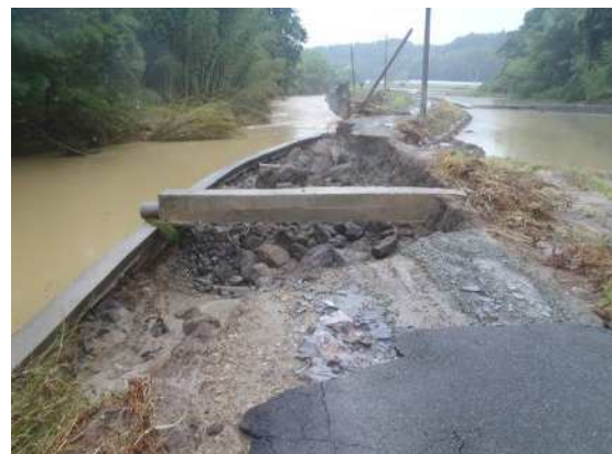
写真 3-1-15 ⑪農道路面崩落（大字教楽来）
