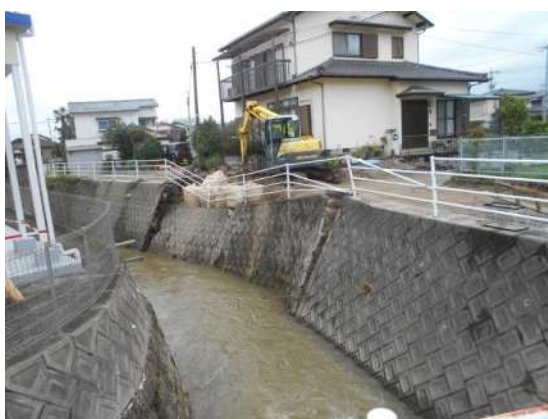
写真 3-1-13 ⑨護岸損傷（堂面川）
