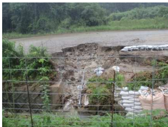
写真 3-1-6 ②護岸損傷による田面の陥没 (大字四ヶ)
