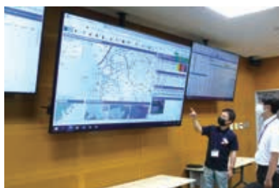
防災専用ネットワークシステム
