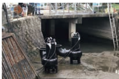
ポンプが増強された三川ポンプ場
