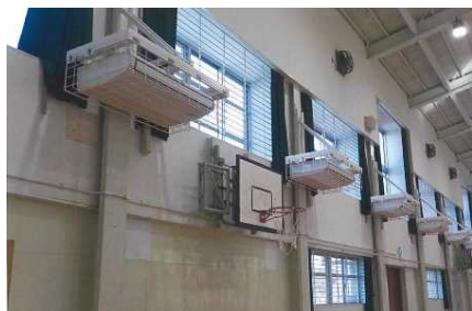
※体育館空調設備 (イメージ)
