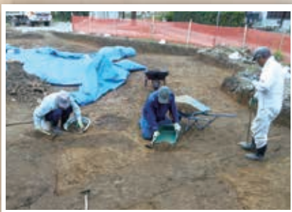
遺跡のある面を削り、遺構であるかを見極めます（こげ茶色の部分が遺構です）
