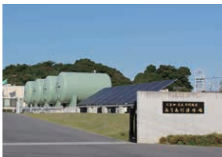
世界遺産・宮原坑に臨む「ありあけ浄水場」は熊本県荒尾市と共同で建設運営しており、県境を越えた共同の浄水場は日本初の取り組みです
