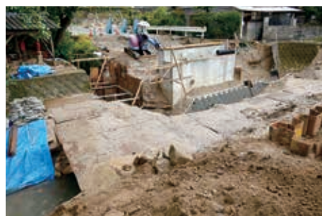
橋梁 復旧途中
