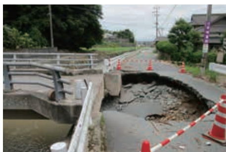
橋梁 被災直後
