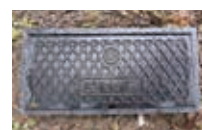
直結止水栓 （メーターボックス）
