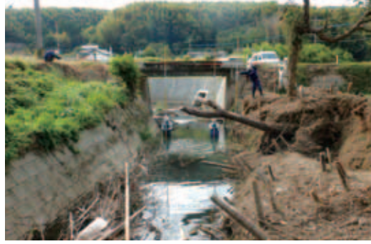
四ヶ地区 公共土木施設 (河川)
