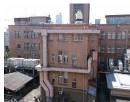
建物の老朽化
