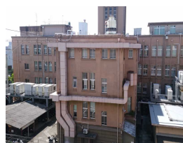
建物の老朽化
