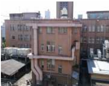
建物の老朽化
