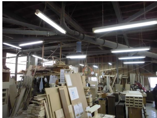
【 工場の蛍光灯 】
