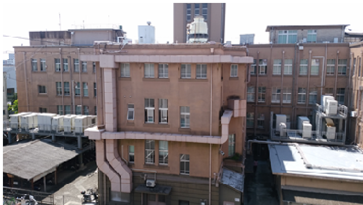
建物や設備の老朽化
