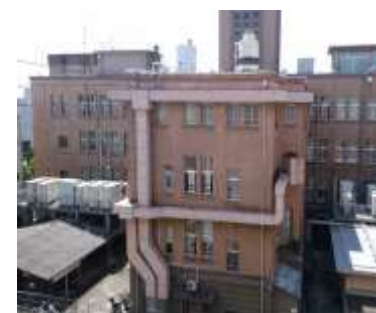
建物の老朽化
