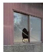
窓が割れた 管理不全空家
