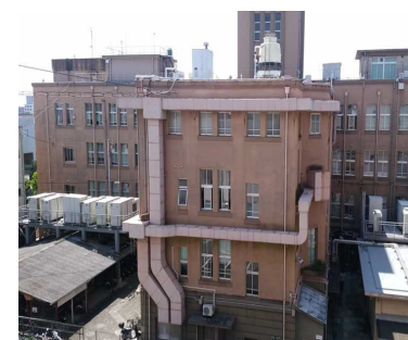
建物の老朽化
