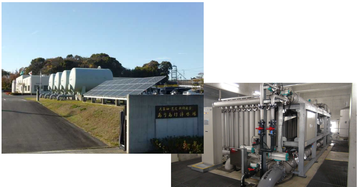
ありあけ浄水場・膜ろ過装置
