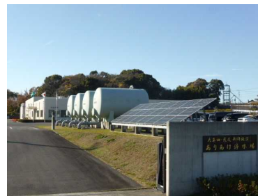
ありあけ浄水場
