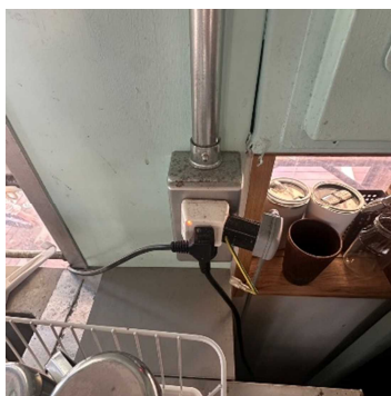
厨房側コンセント①
