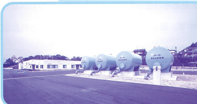
じょうすいじょう ありあけ浄水場 平成24(2012)年完成
