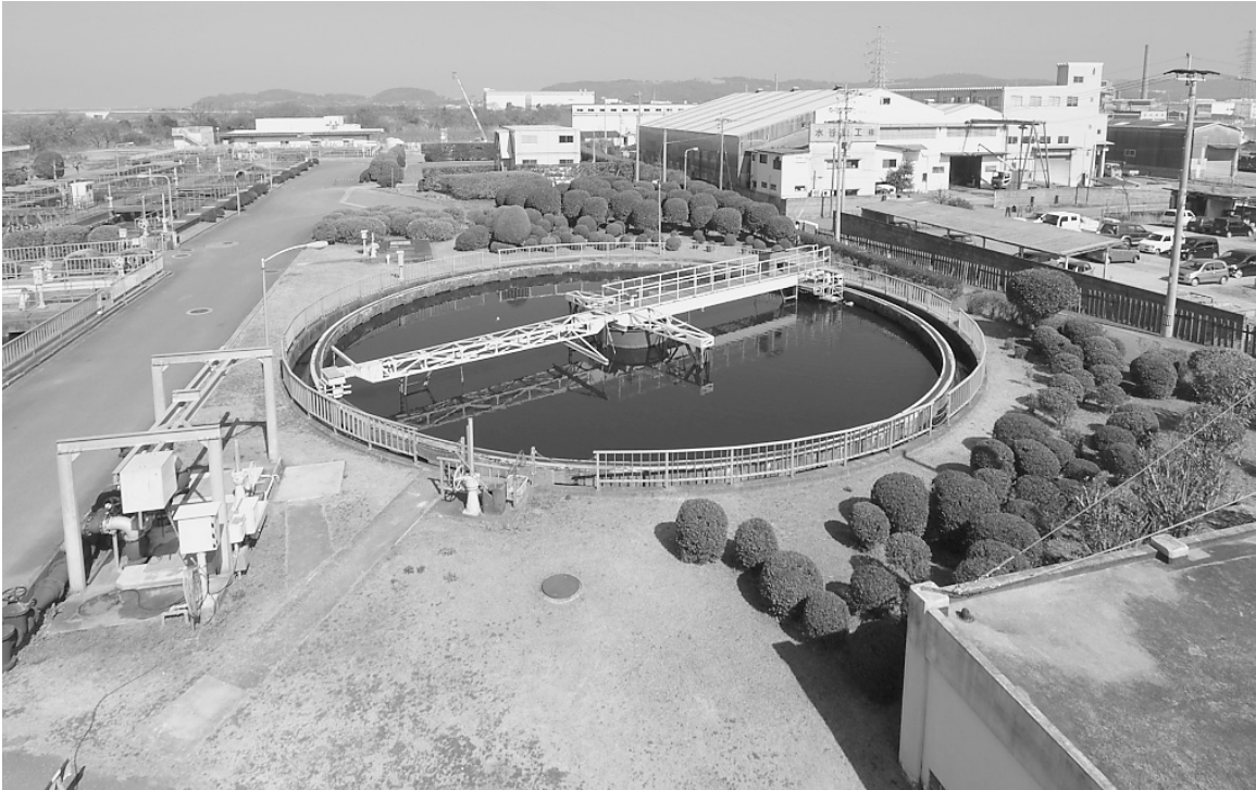
北部浄化センター 最終沈澱池
