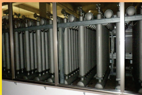
膜ろ過ユニット (ありあけ浄水場)
